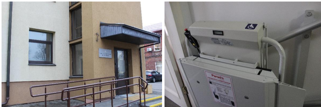
Kelmės rūmuose įrengtas pandusas ir elektrinis keltuvas.
